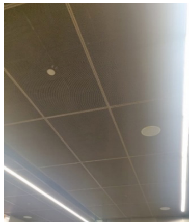
RAJAH 7. Penggunaan panel siling aluminum berongga di stesen MRT Cochrane
