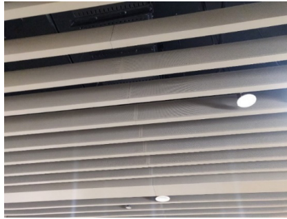
RAJAH 6. Penggunaan panel siling aluminum berongga di stesen MRT Cochrane
