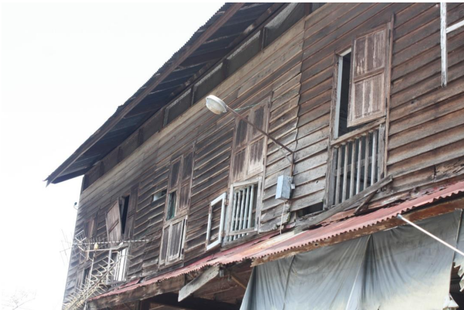
Foto 15. Jendela Lot no. 1, 2 dan 3 yang masih berdaunkan asal dan telah mengalami kerosakan kritikal. Bahagian dinding turut reput khususnya yang bersambung dengan sengkuap ( awning ) zink depan Sumber: Kajian lapangan 25/3/2014
